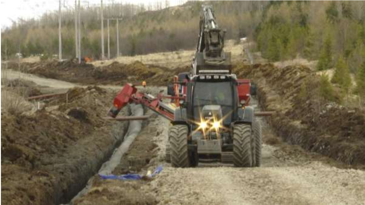
Mynd 8. Mynd úr frétt RÚV um tvöfalt strengsett í Hólasandslínu 3 sem raski 20 metra belti
